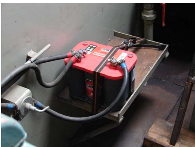
Deze startaccu staat niet goed vast, de accu klemmen zijn niet geïsoleerd en de kabels zitten niet goed vast in de klemmen. Beter is het om kabelschoenen aan de kabels te persen en deze met een krimpkous te isoleren.
