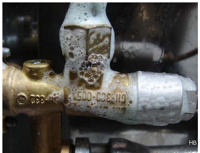
De oorzaak van de minieme lekkage was een ondichte koppeling onder het gasstel.
